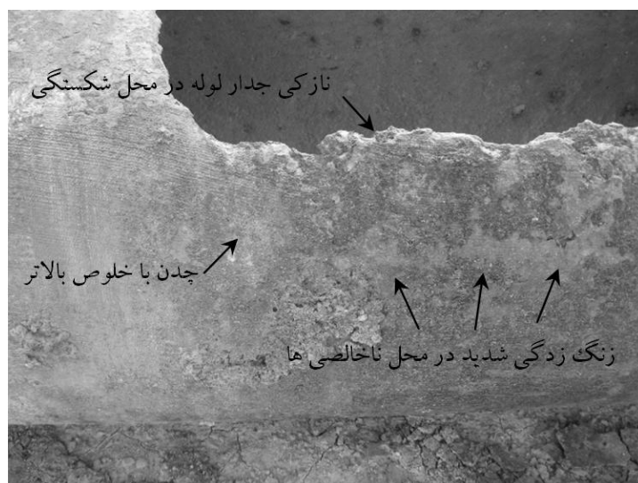
شکل ۱۱ زنگ‌زدگی شدید سطح خارجی لوله در محل بروز حادثه
