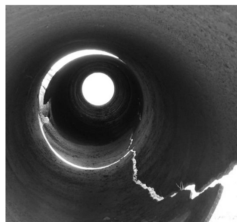
شکل ۸ شکست طولی لوله خط انتقال گیسور-گناباد ناشی از فشارهای گذرای مثبت و منفی
