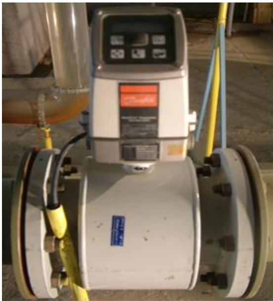
Fig. 4 Flowmeter installed in the model شکل ۴ دی‌سنج نصب شده در مدل
